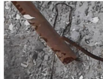
Gambar 10. Karat menyeluruh pada safety net anchor
