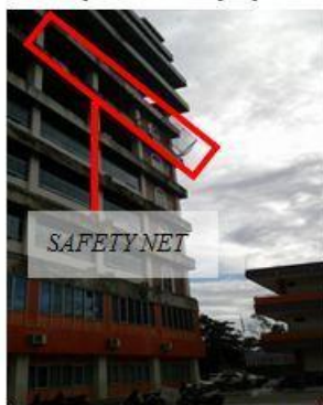
Gambar 1. Safety Net pada sisi kanan Gedung rektorat UNIBA
