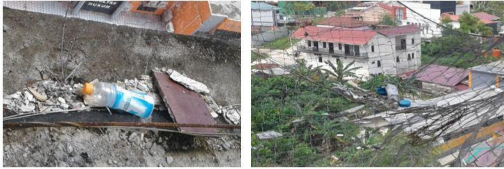
Gambar 7. Terdapat benda asing tertumpuk pada safety net mesh
